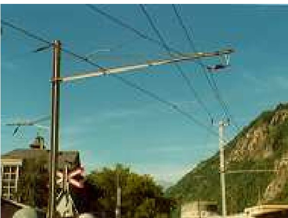
Bild 1.4: Windschiefe Kettenfahrleitung im FO-Bahnhof Brig.
