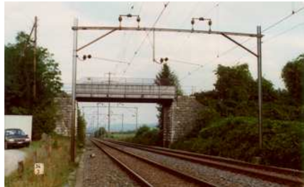
Bild 1.1: SBB-Fahrleitung älterer Bauart bei Gundetswil.
