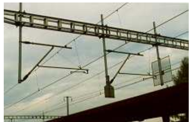
Bild 1.2: Moderne R-Fahrleitung der SBB in Bassersdorf
