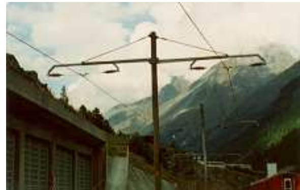
Bild 1.5: Einfachfahrleitung im Abstellbereich des Bahnhofes Zermatt der BVZ. Gleichartige Holzmasten waren auch auf der alten FO-Bergstrecke zu sehen
