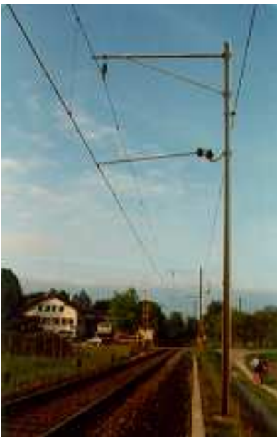
Bild 1.3: Das Bild zeigt eine Fahrleitung, wie man sie häufig auf Schweizer Nebenbahnen antreffen kann. Strecke Winterthur-Hettlingen
